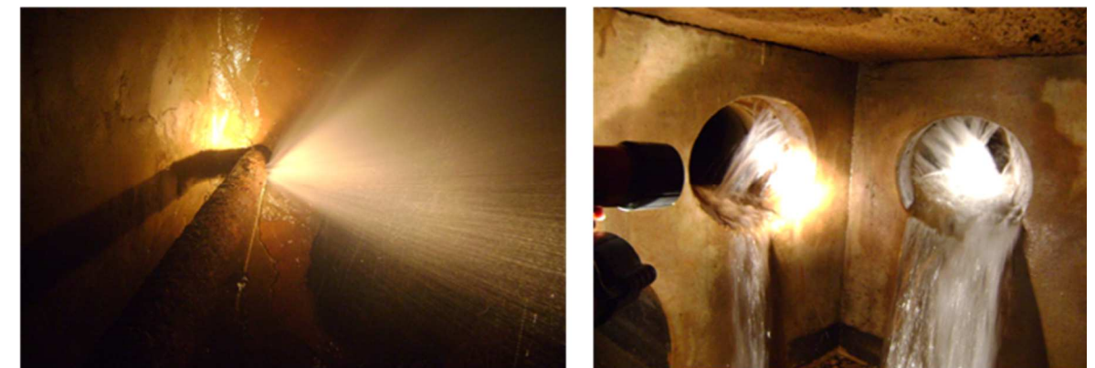
Figura 24. Vazamentos não visíveis
